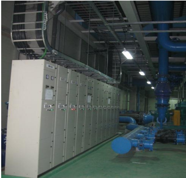
Hệ thống cơ điện đã hoàn thành M&E System completed
