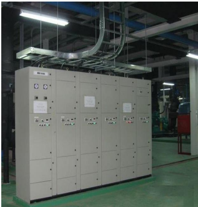
Hệ thống cơ điện đã hoàn thành M&E System completed
