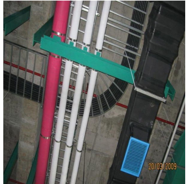
Hệ thống cơ điện đã hoàn thành M&E System completed
