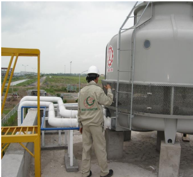
Tháp tản nhiệt Cooling Tower
